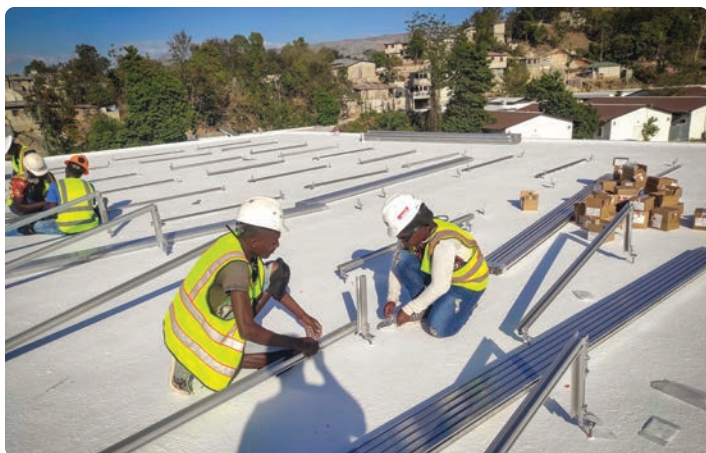
Les membres de l'équipe installent les supports qui accueilleront les nouveaux panneaux solaires sur le toit de HUM. Photo de Jimmy Forest pour PIH
